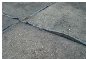
アスファルト防水・押え仕様 (保護層伸縮目地の突出)
