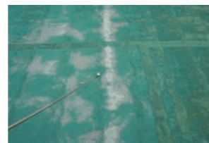
ウレタン塗膜防水 (トップコートの消失)
