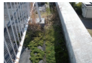
露出アスファルト防水 (植物の繁茂・コケの発生)
