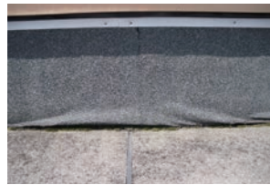
アスファルト防水・押え仕様 (立上り防水層の破断)
