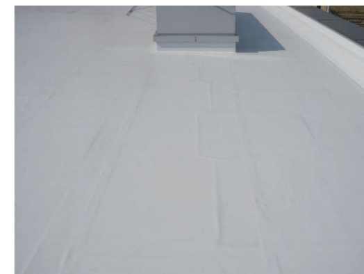
断熱材の段差
