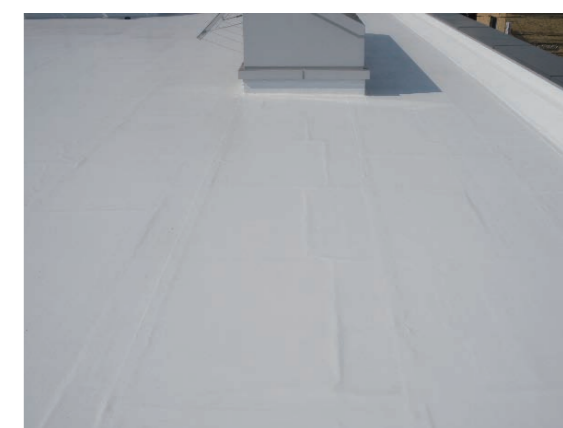
断熱材の段差
